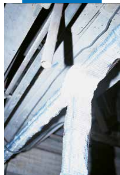
Struttura in calcestruzzo degradato
